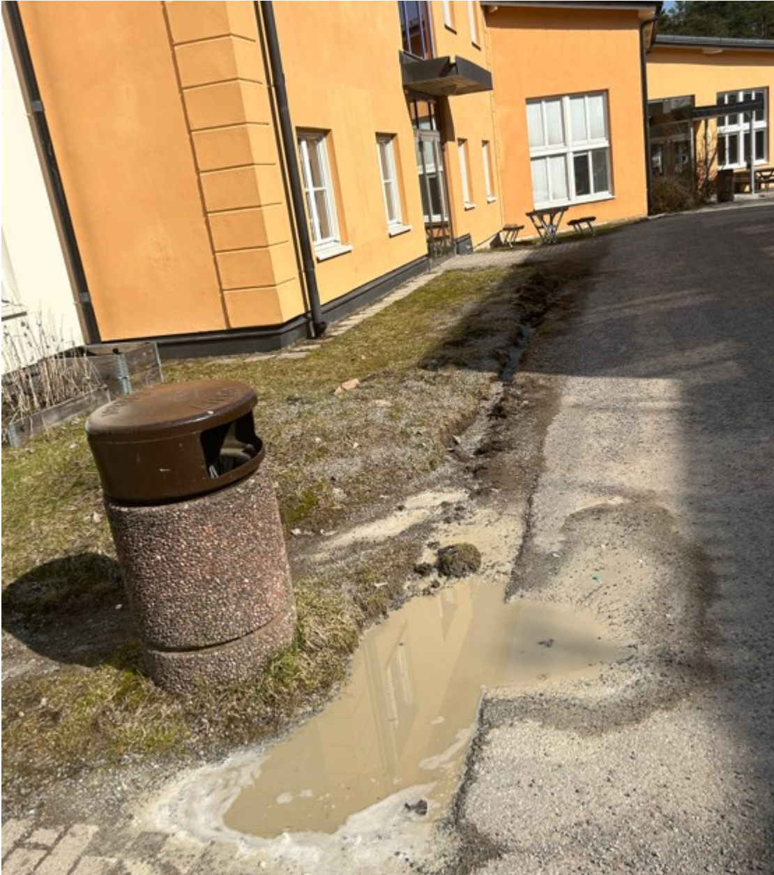
Figur 26. Stående regnvatten mellan hus 2 och 3 (Foto: platsbesök Norconsult)
